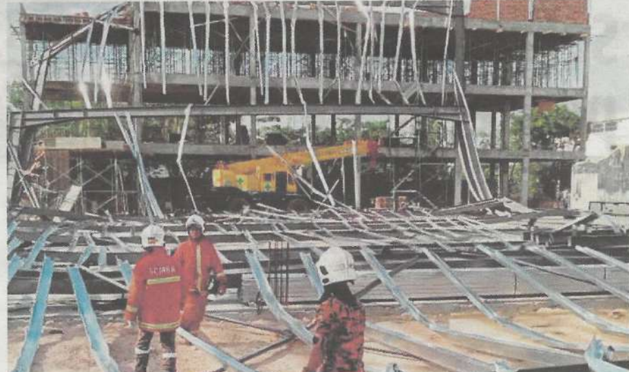
Tiang dan kerangka bumbung runtuh di sebuah tapak pembinaan di Lorong Perusahaan Maju 8, Bukit Mertajam, yang meragut tiga nyawa, semalam
