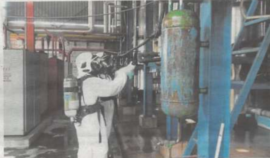
Anggota HAZMAT memeriksa mesin yang bocor di sebuah kilang ais di Shah Alam, semalam.
