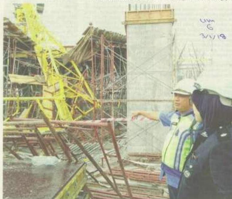
KEADAAAN kren menara yang runtuh dan mengorbankan seorang pekerja sebuah tapak pembinaan di Seksyen 7, Shah Alam, Selangor, semalam.
