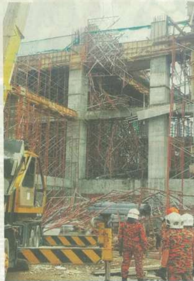
ANGGOTA bomba dan penyelamat melakukan kerja-kerja mencari mangsa tertimbus akibat runtuhan struktur bangunan di Jalan Cochrane, Kuala Lumpur, semalam.
