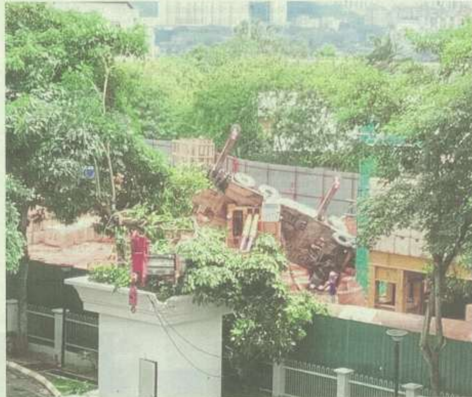
Kren di tapak pembinaan projek perumahan tumbang ke pekarangan letak kenderaan kondominium dekat Taman Desa, Kuala Lumpur, semalam.
