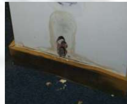
Gambar 5: Rekahan pada bangunan yang tidak dibaiki
