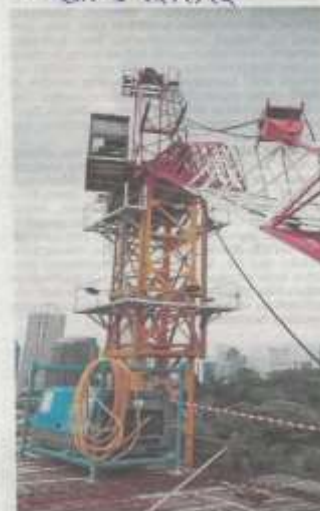
Sebuah kren menara patah di Bukit Ceylon, Kuala Lumpur, semalam.
