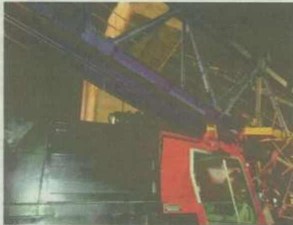
KEADAAN gelangsar gantri yang tumbang sehingga menyebabkan seorang maut di tapak pembinaan MRT di Jalan Jinjang, Kuala Lumpur kelmarin.
