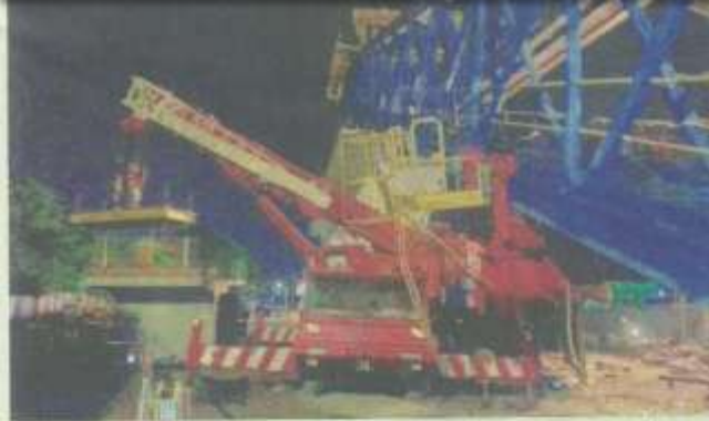
KEADAAAN gelangsar gantri yang jatuh dan mengorbankan seorang pekerja di Tapak pembinaan Jalan Injong, Kuala Lumpur, semalam. - HUSAN BOWSA
