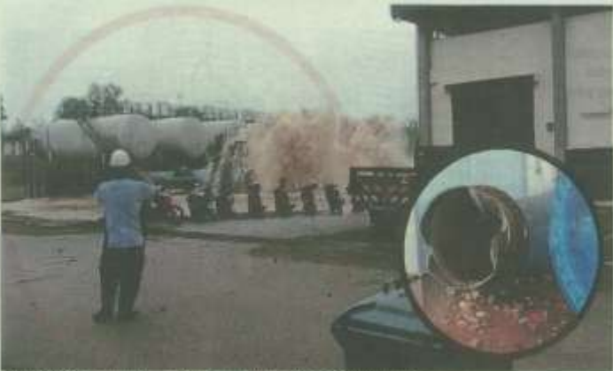
KEADAAN sistem mampatan udara di Loji Rawatan Air SSP3 yang pecah.
