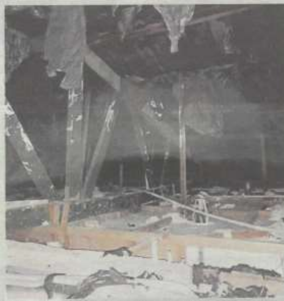
SILING rumah mangsa terbakar 25 peratus dalam kejadian di Kampung Berunding, kelmarin. HM 2 23/3/19
