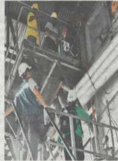
PASUKAN penyiasatan JKKP memeriksa dandang stim lokasi Ravindran terjauh sebelum maut ketika melakukan kerja-kerja penyelenggaraan di sebuah kilang kelapa sawit di Lumut semalam.
