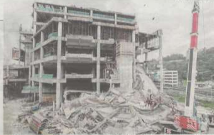
Struktur binaan di lokasi pembinaan Terminal Bas Bersepadu Gombak, runtuh mengurangkan dua wargu Indonesia.
