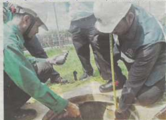
Pegawai JKKP Perak bersama pegawai Bahagian Higien Industri dan Ergonomik, JKKP Putrajaya menjalankan pengujian gas dalam ruang terkurung saluran gas bawah tanah di Jalan Ipoh-Lumut.
