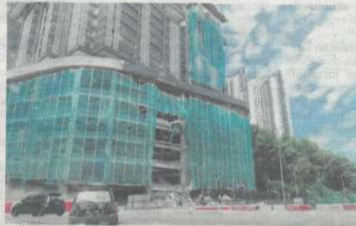
INILAH bangunan pangsapuri 34 tingkat yang sedang dalam pembinaan semasa pelantar yang digunakan runtuh sehingga menyebabkan empat pekerja cedera di Wangsa Maju, Kuala Lumpur kelmarin.
