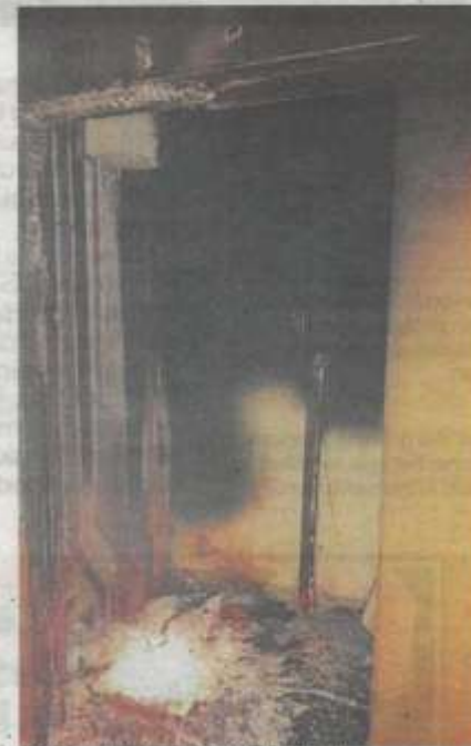
INILAH tempat seorang pekerja penyelenggaraan melecur dalam kebakaran di sebuah bilik salur elektrik di Wisma Punca Emas, Negeri Sembilan semalam.
