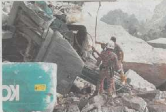
PASUKAN penyelamat mengikat tali besi untuk mengalihkan jengkaut yang terbalik dihempap runtuhan batu di kawasan kuari Sungai Raia, Ipoh semalam.
