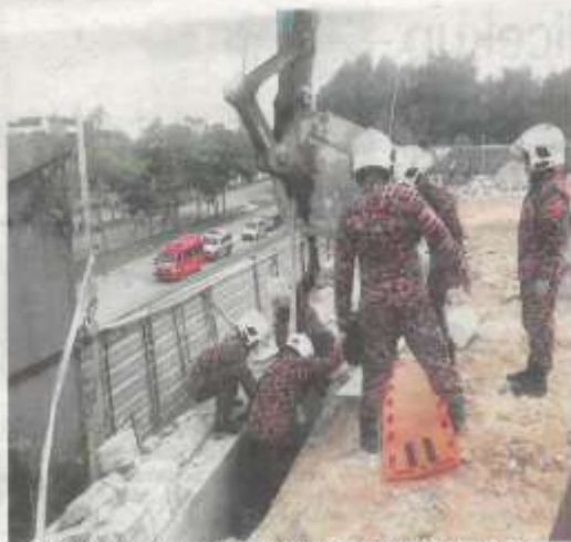
ANGGOTA bomba mengeluarkan mangsa daripada runtuhan konkrit di Seksyen U16, Denai Alam semalam.
