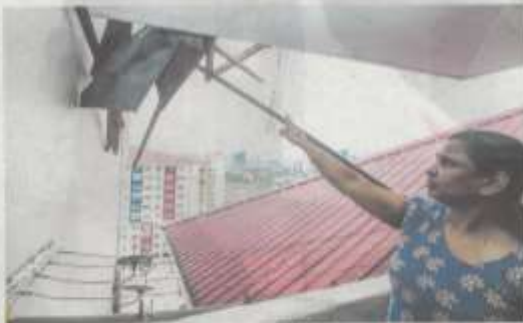
THARAVATTUR menunjukkan bumbung yang rosak akibat ribut.
