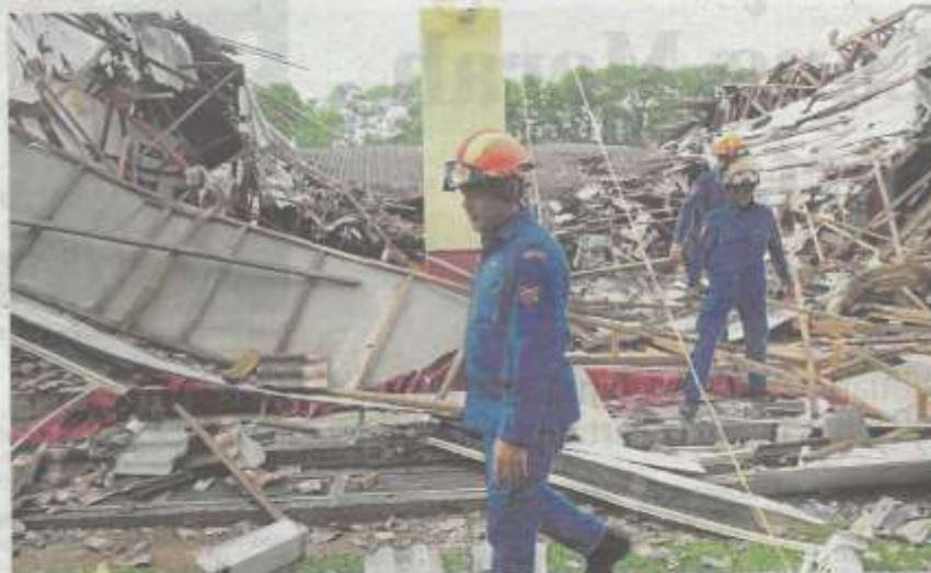
Anggota Angkatan Pertahanan Awam memeriksa kesan runtuhan bumbung bangunan kantin Sekolah Kebangsaan Siol Kanan, Petra Jaya, semalam. (Foto BERNAMA)
