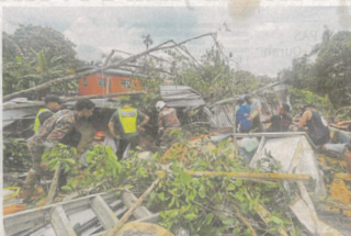
Projek bomba menyelidiki punca tanah runtuh di Kampung Mook, Paper, Selasa.
